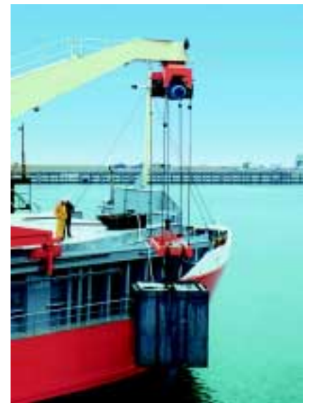
Kein Schaukeln der Ladung: HÜBNER Kombinationen HOG 10 + ESL (Digital-Tacho + elektronischer Drehzahlschalter) regeln und überwachen die Bewegung der AC-Bremsmotoren.
